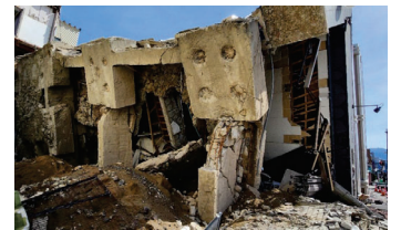
基礎はりの鉄筋が曲がっている様子（座屈と呼ぶ）
