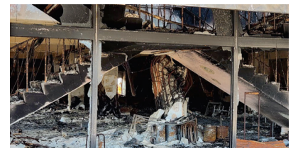
外柱の損傷は少ない。写真では中柱のせん断破壊の様子。
