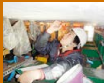
輪荷重走行試験後の床版のひび割れ観察
